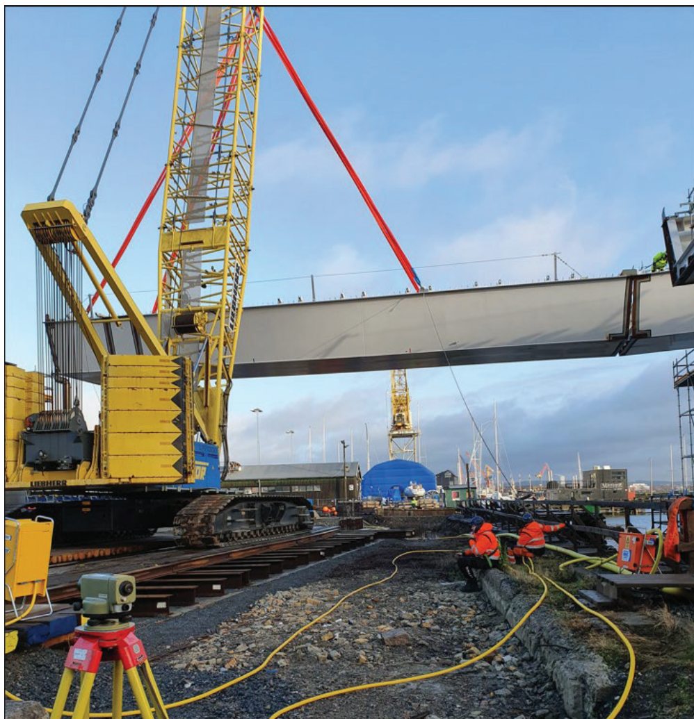
Figur 21 Bild som visar när larvkranen lyfter brobalk N5E på plats. Avvägningsinstrumentet i förgrunden användes för avvägning av upplagskonstruktionen under lyftet.
