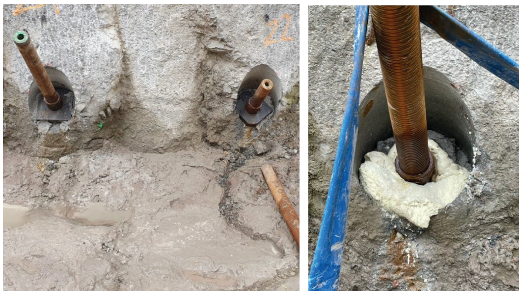
Figur 33 Till vänster inläckage efter borrhning och till höger tätning efter provdragning och förspänning.
